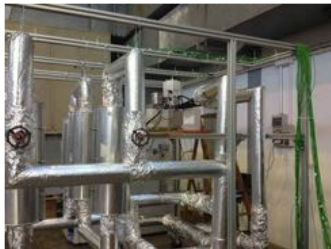
Impianto sperimentale ATES
