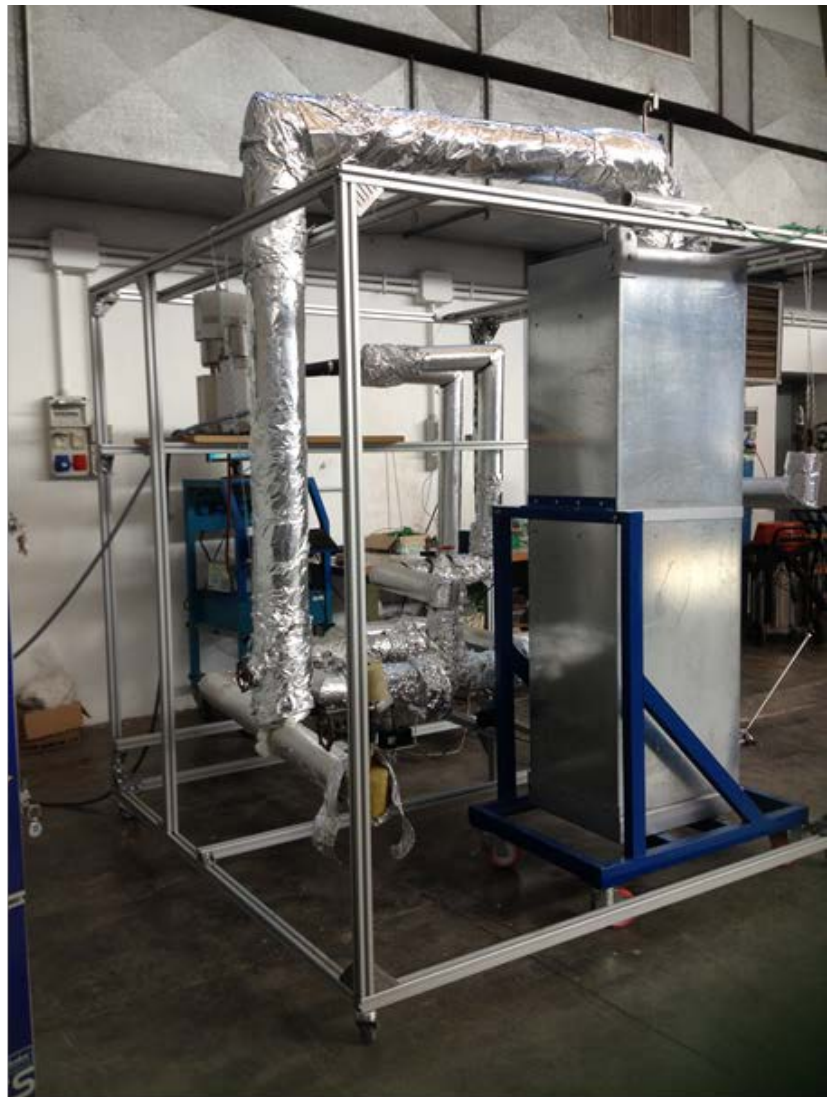
Impianto Ates nella sua configurazione con un serbatoio di stoccaggio termico e scambiatore di calore integrato, contenente circa 100 kg di sali solari
