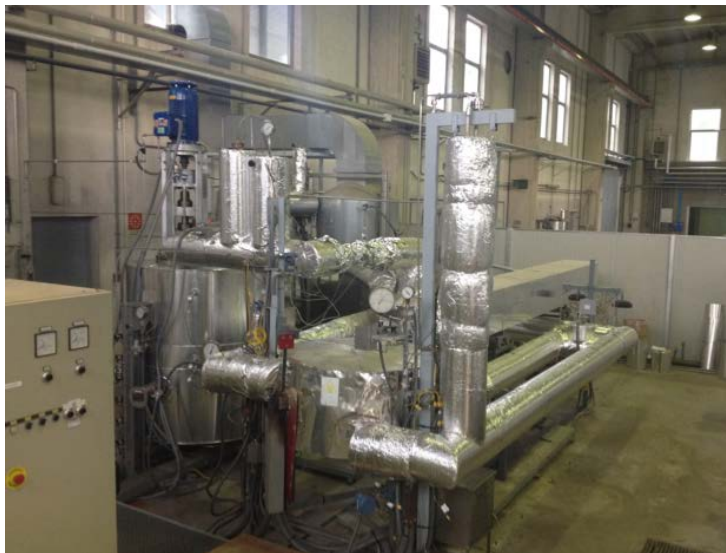
Impianto MoSE – circuito sale
