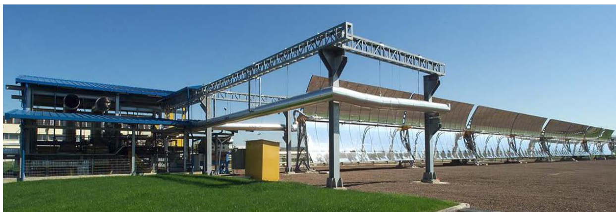
Foto d'insieme dell'impianto PCS
