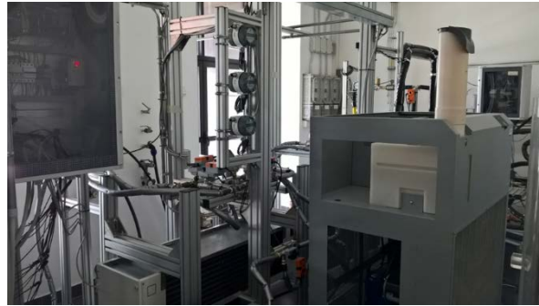
Foto impianto prova accumulo del "freddo"
