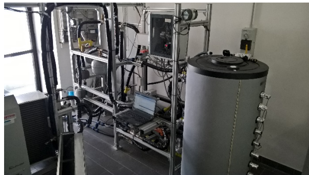
Foto impianto prova accumulo a medio-bassa temperatura
