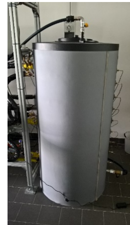
Serbatoio di accumulo con flangia in testa
