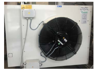
Scambiatore per la simulazione del carico termico
