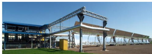
Impianto prova collettori solari (C.R. ENEA Casaccia)
