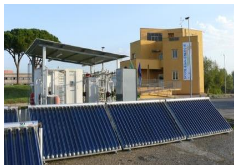
Impianto di solar heating and cooling a servizio di un edificio del C.R. ENEA Casaccia
